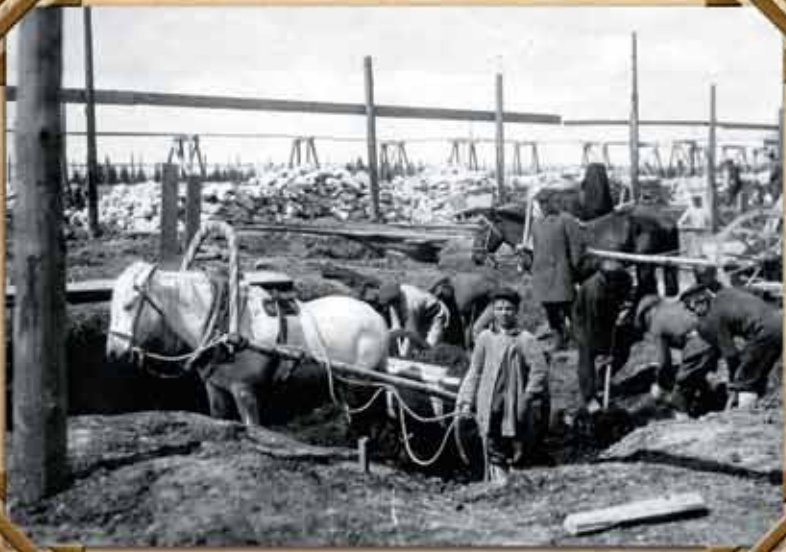
Выемка грунта и перевозка его с помощью подвоя на строительстве завода, 1932 год.
